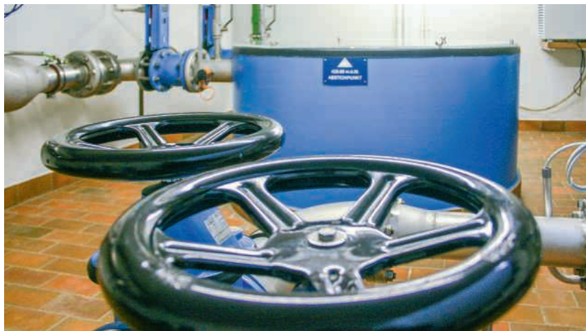
Einblick ins Grundwasserpumpwerk Böldleren
